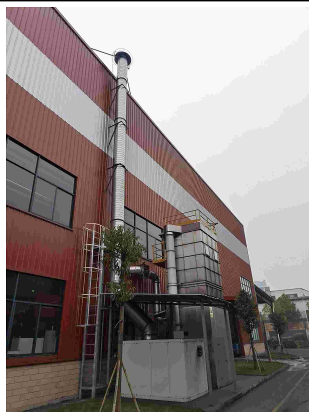
系统 4 布袋除尘器+排气筒 (DA0010)
