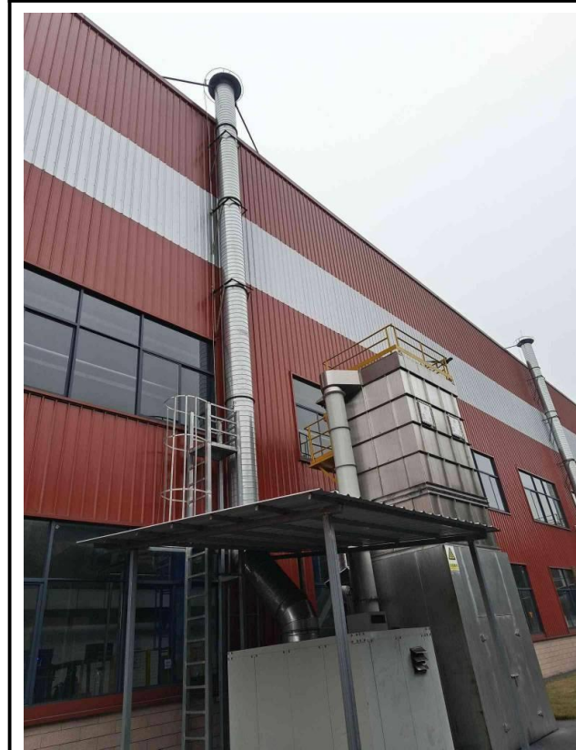
系统 3 布袋除尘器+排气筒 (DA009)
