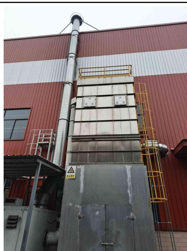
系统 2 布袋除尘器+排气筒 (DA008)
